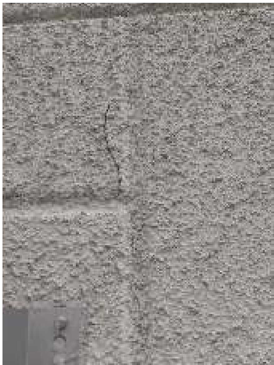
モルタルの細いひび（ヘアクラック）と目地
