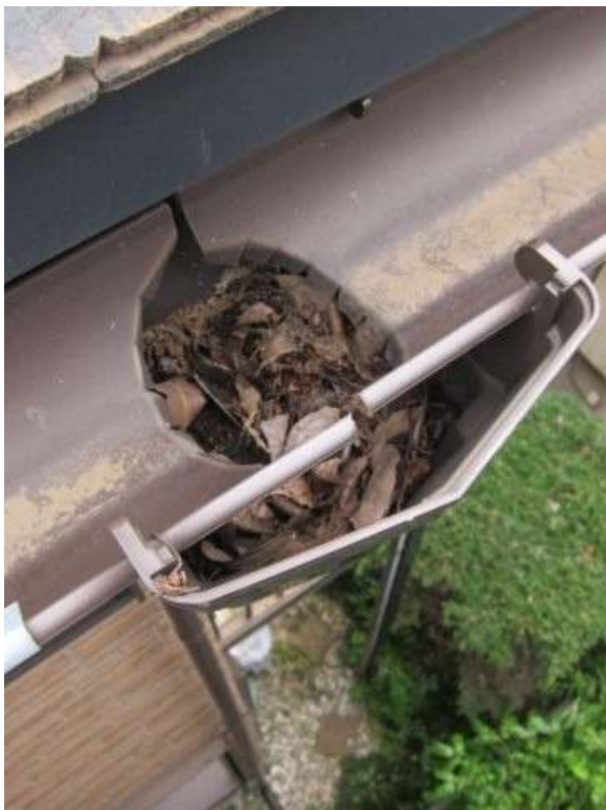
落ち葉・ゴミが詰まった雨樋
