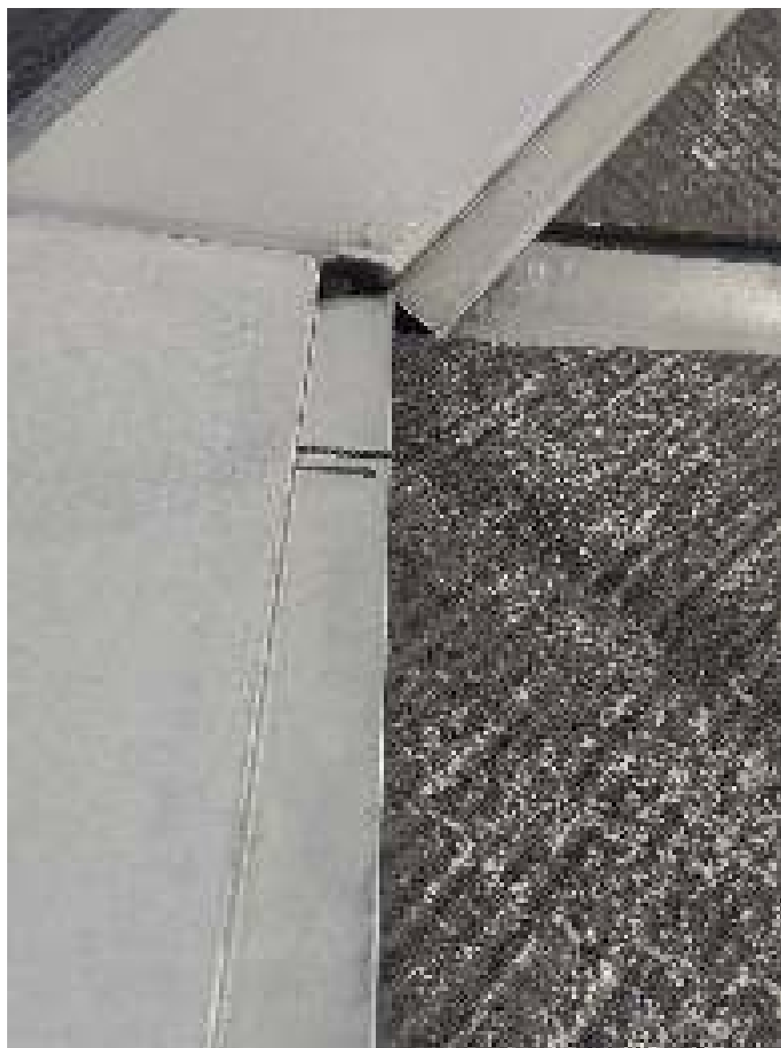
板金の取り付け部分。隙間から雨水が入りやすい
