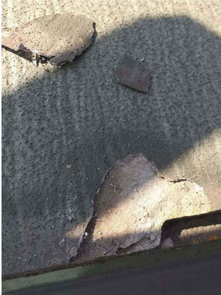
スレート瓦のひび・欠け。 雨水が入りやすい状態
