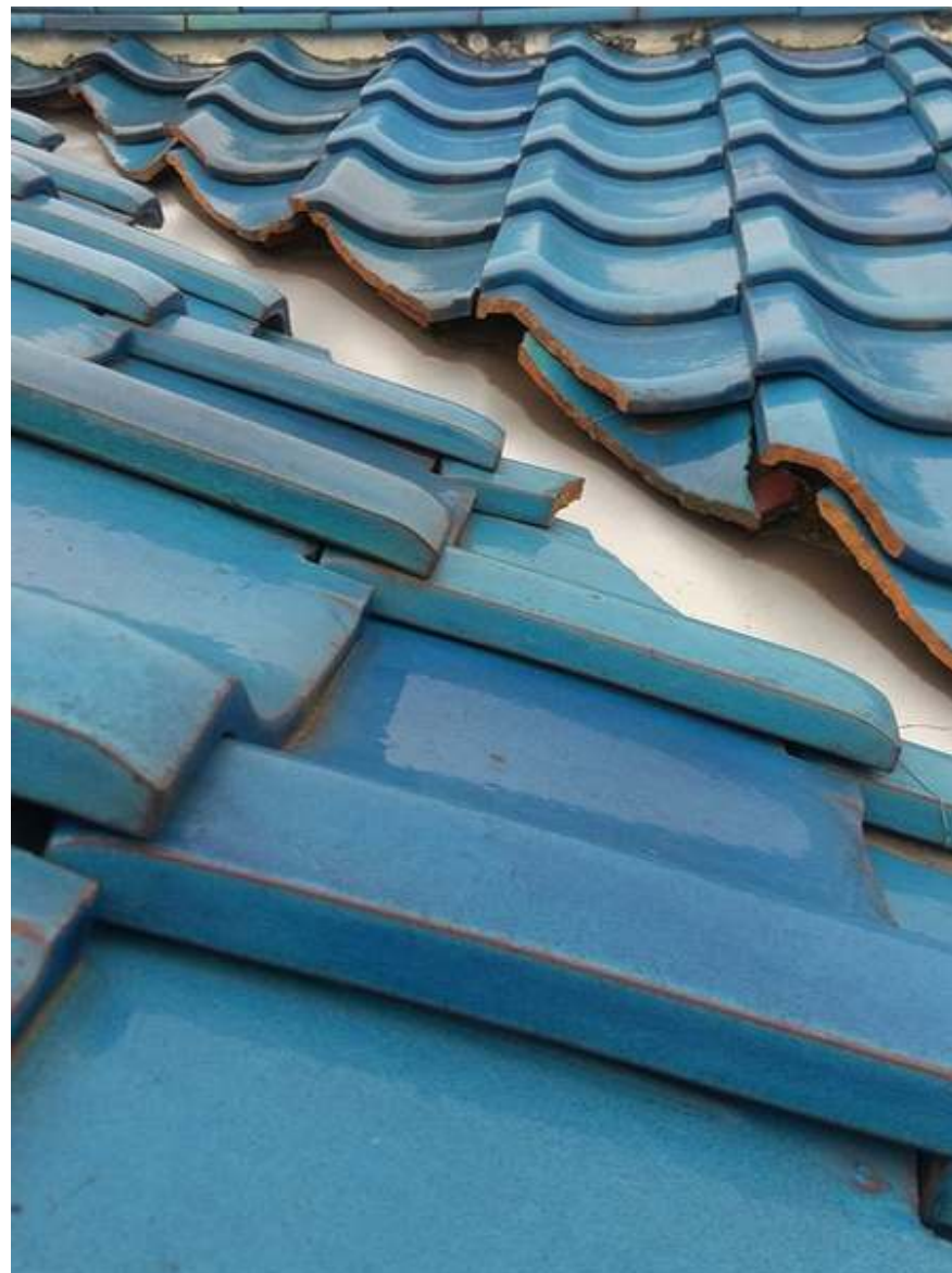
棟漆喰の劣化、瓦の下に雨が 入る状態
