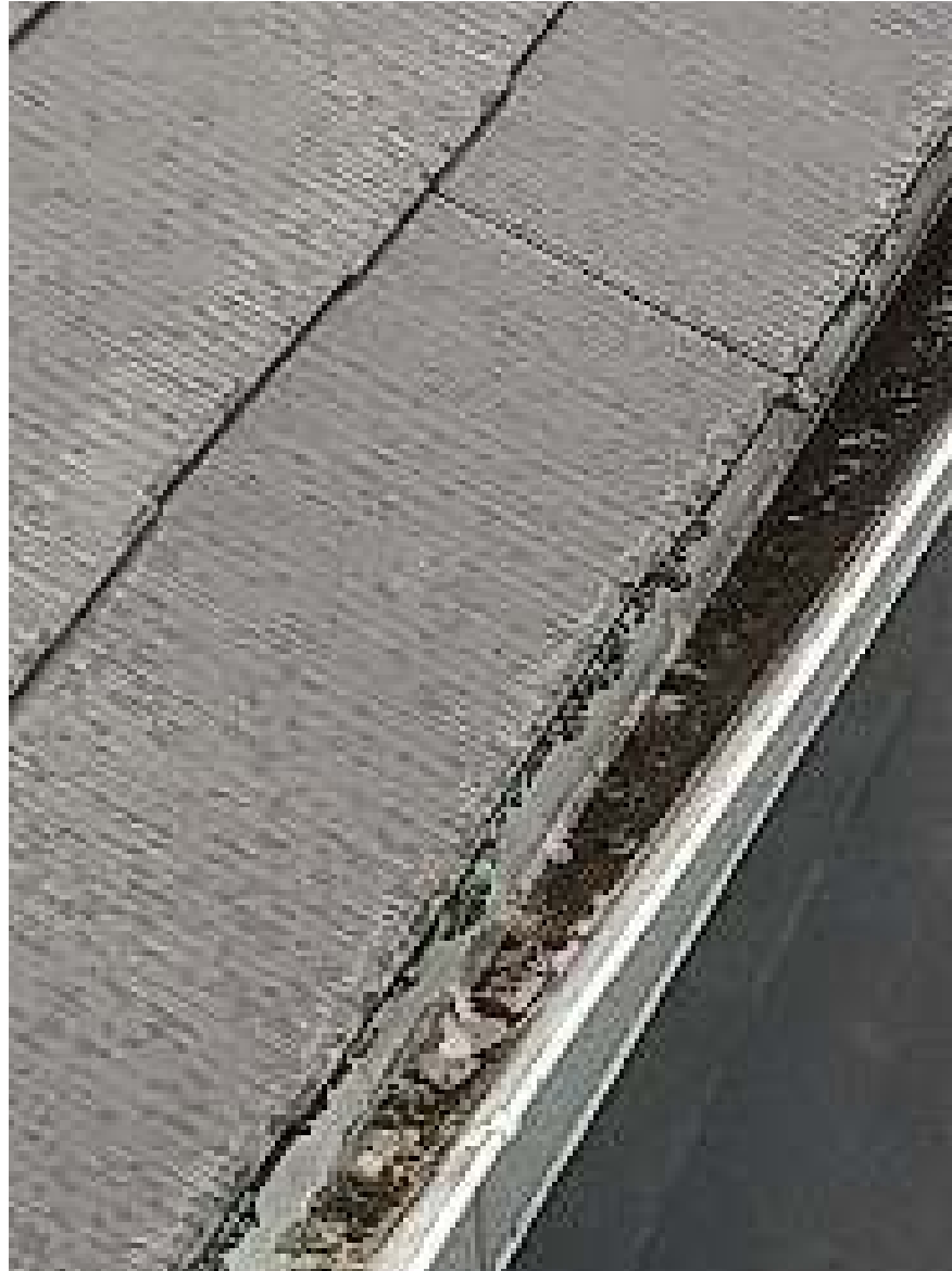
軒先のコケ・表面の破損劣化
