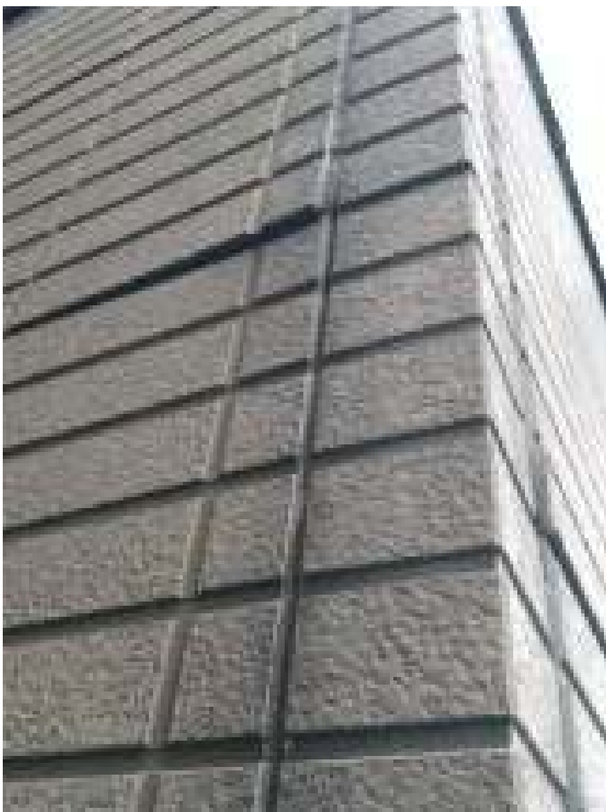
サイディングの剥がれ。目地の黒ずみにも注意
