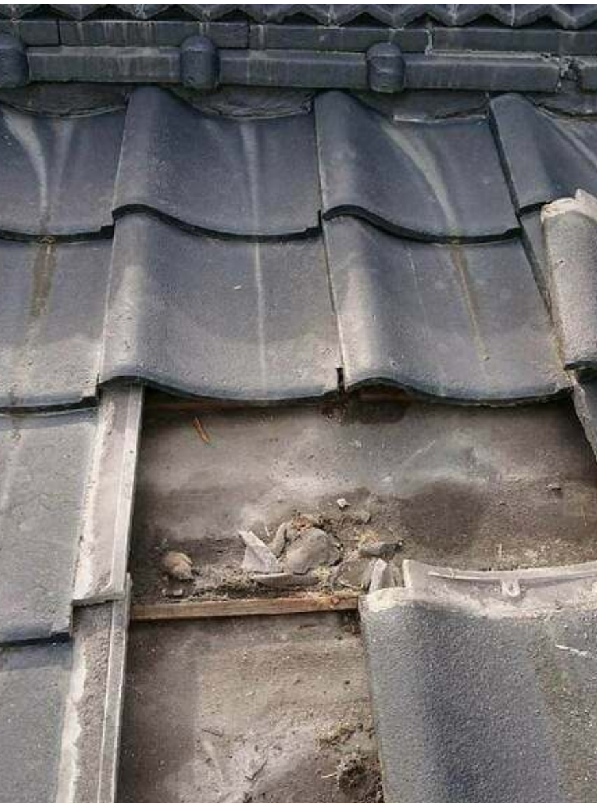
瓦の下の防水シートの破れ、劣化
