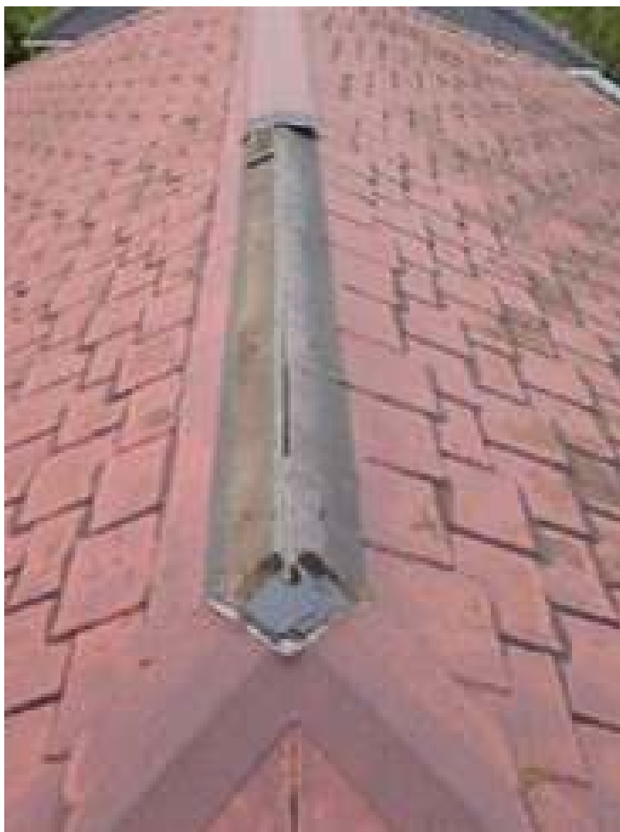
棟板金の剥がれ・脱落。釘の浮きは、台風の後には必ず確認
