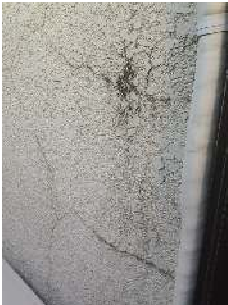
モルタルの黒ずみとひび割れ
