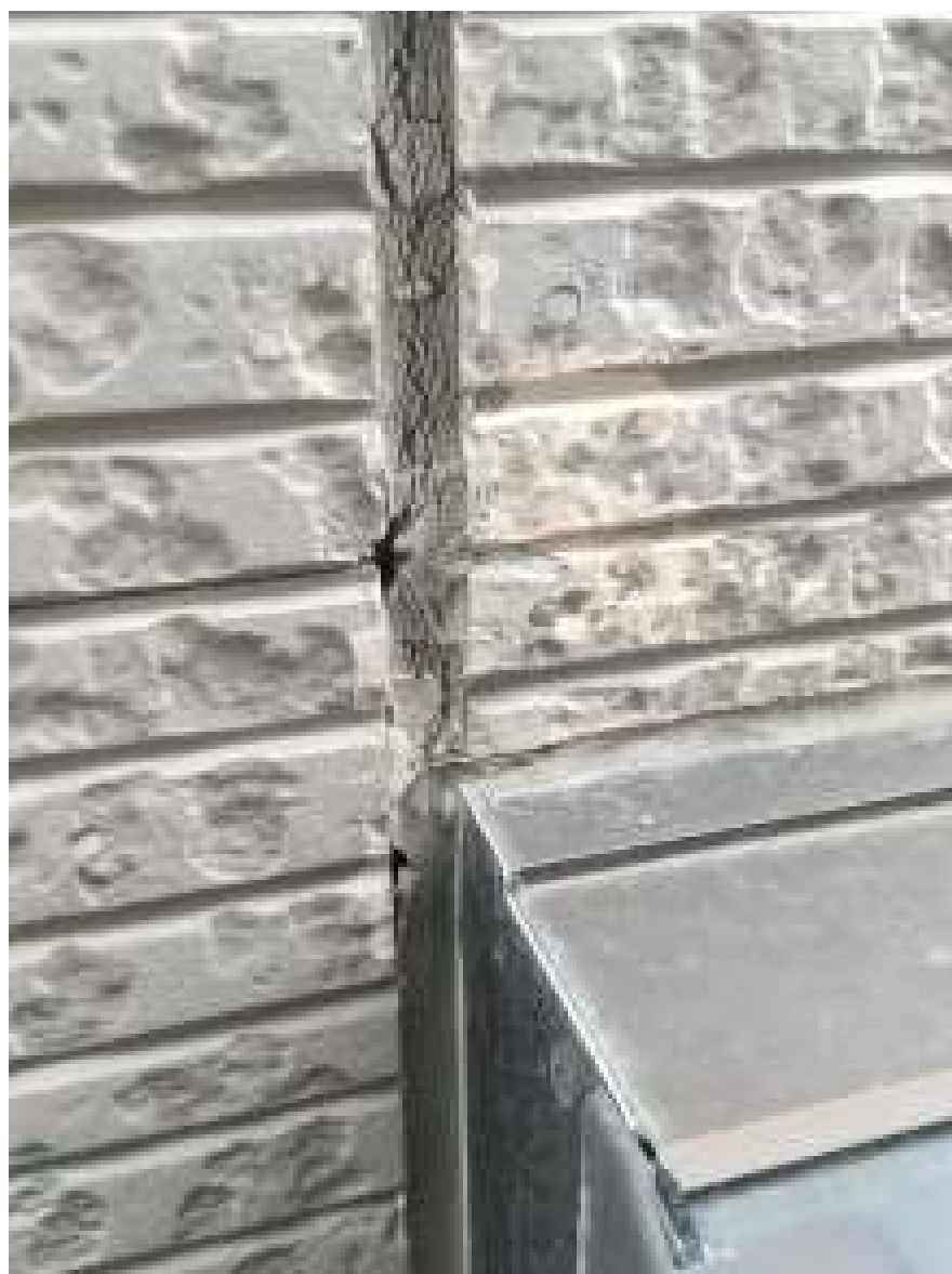
打ち替えが必要な、劣化が進んだ目地
