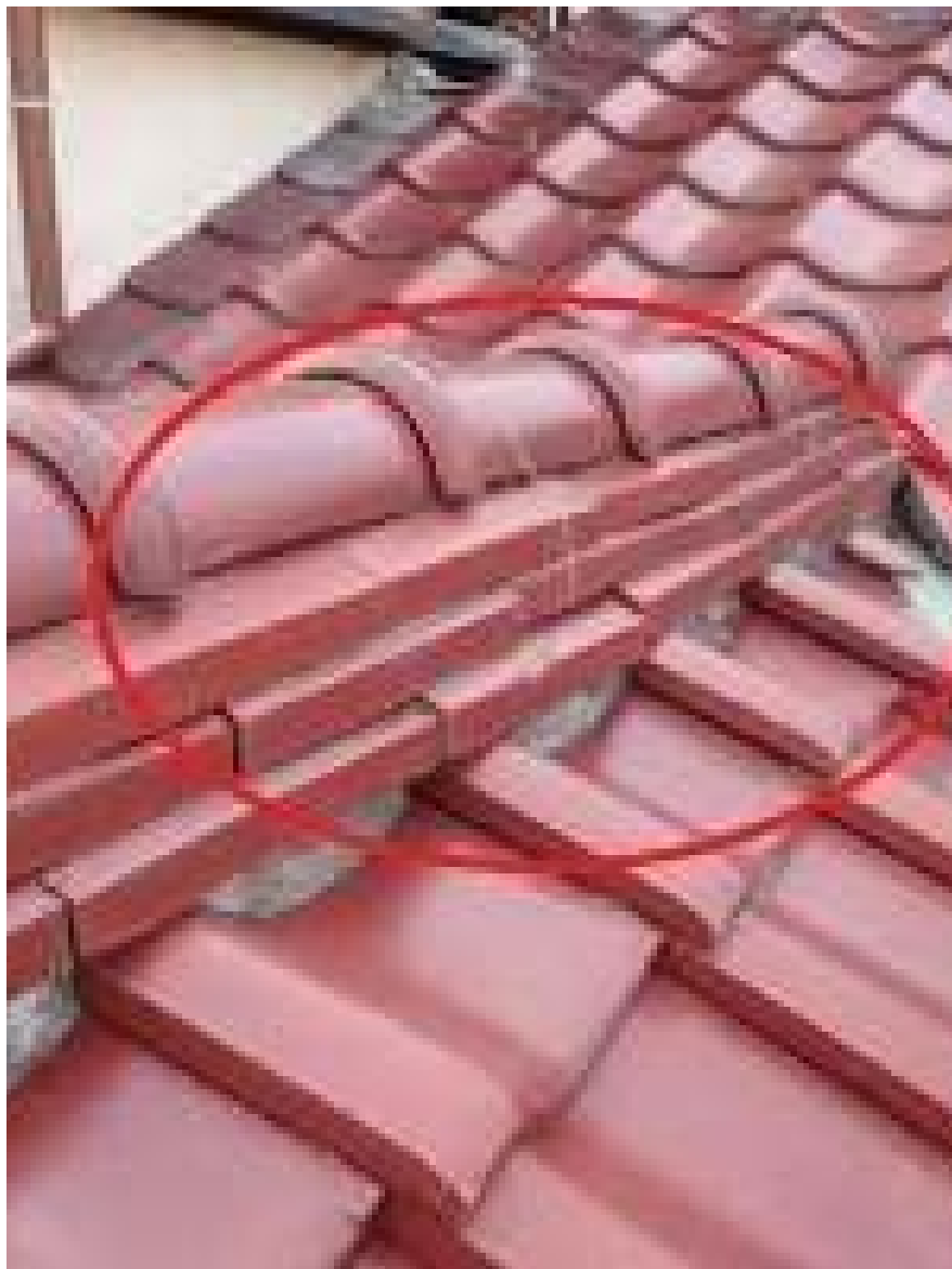
瓦の棟（頂上部）のずれ・漆喰の傷み
