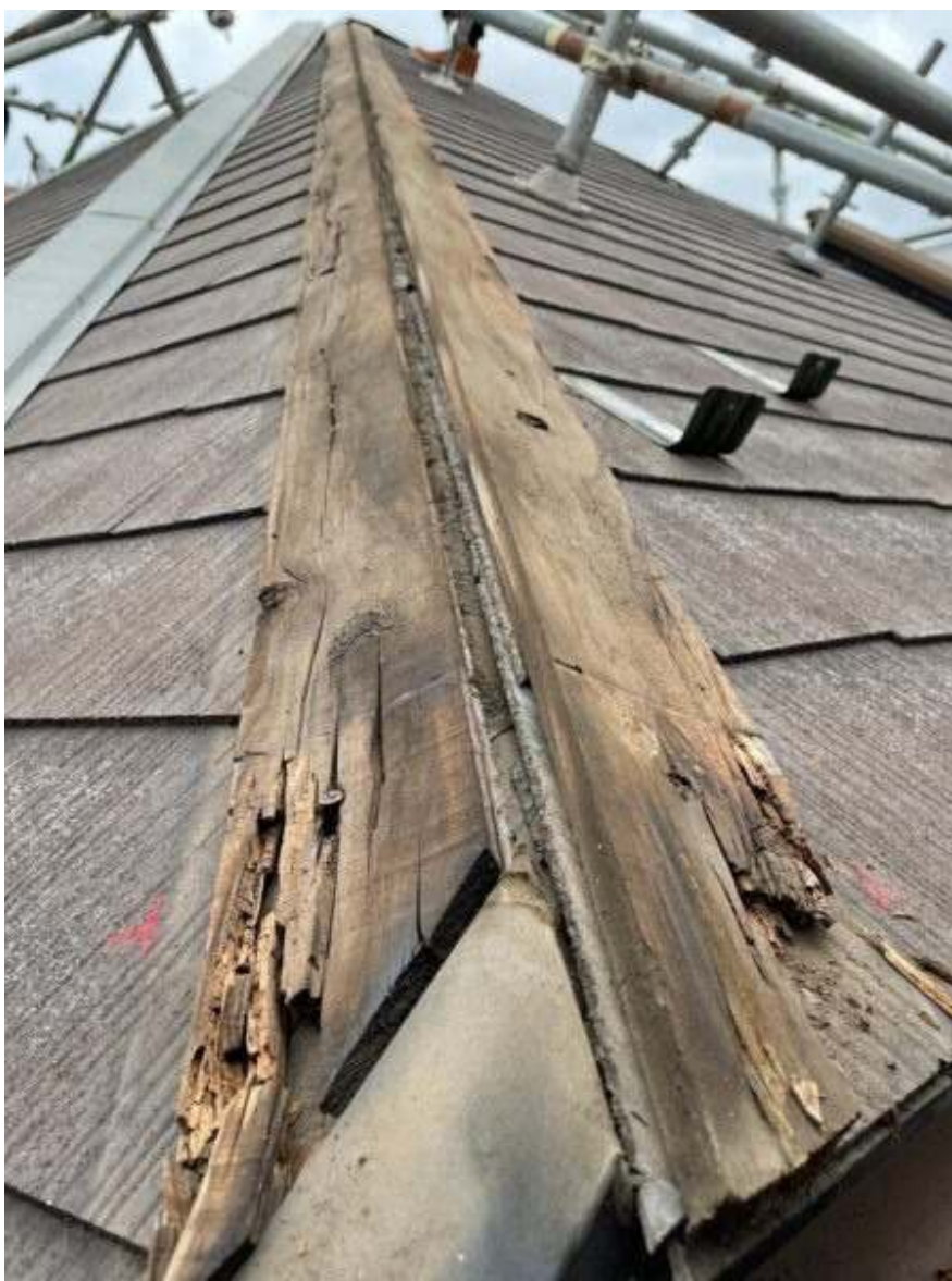
棟板金の下、貫板の腐食
