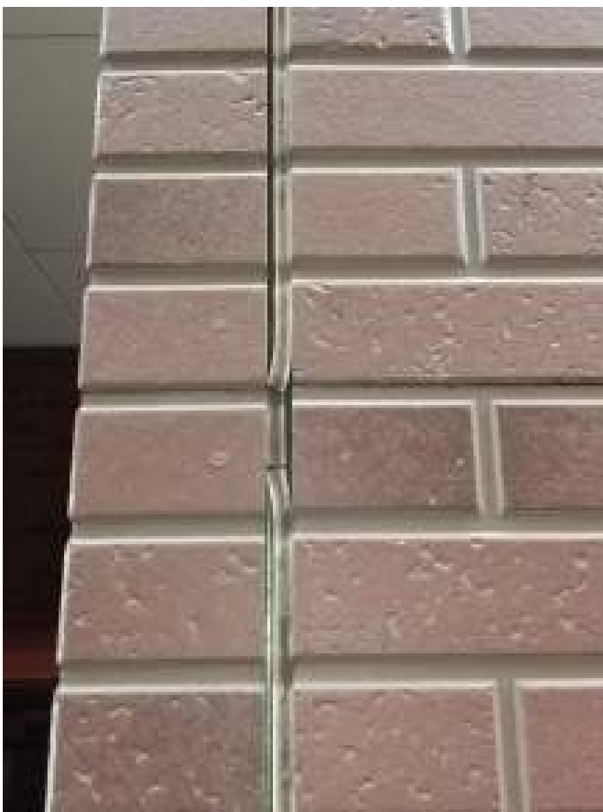
レンガ調サイディングの目地。ゴムが硬化し、割れ・すき間
