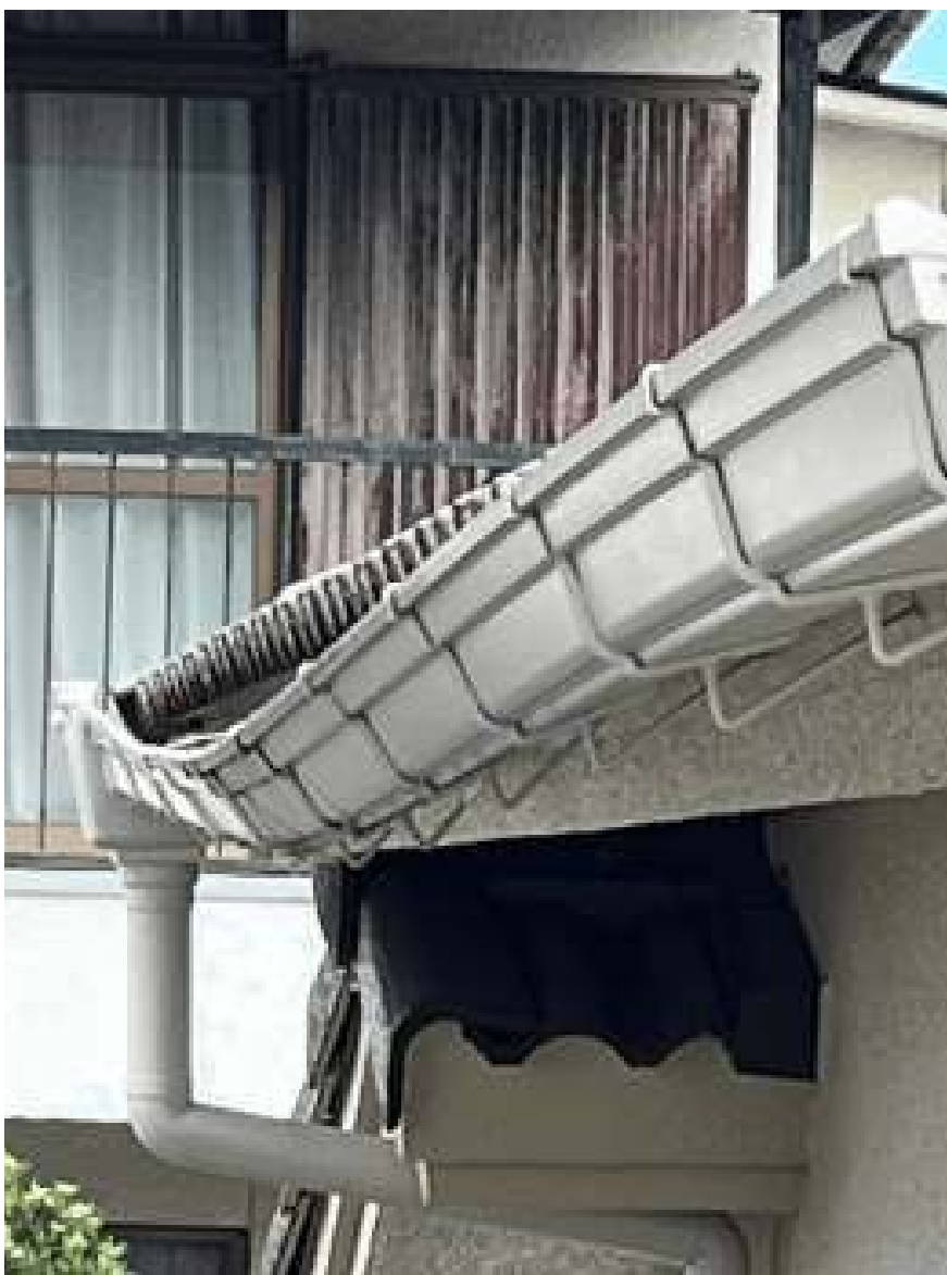
軒樋（横の樋）のゆがみ・外れ
