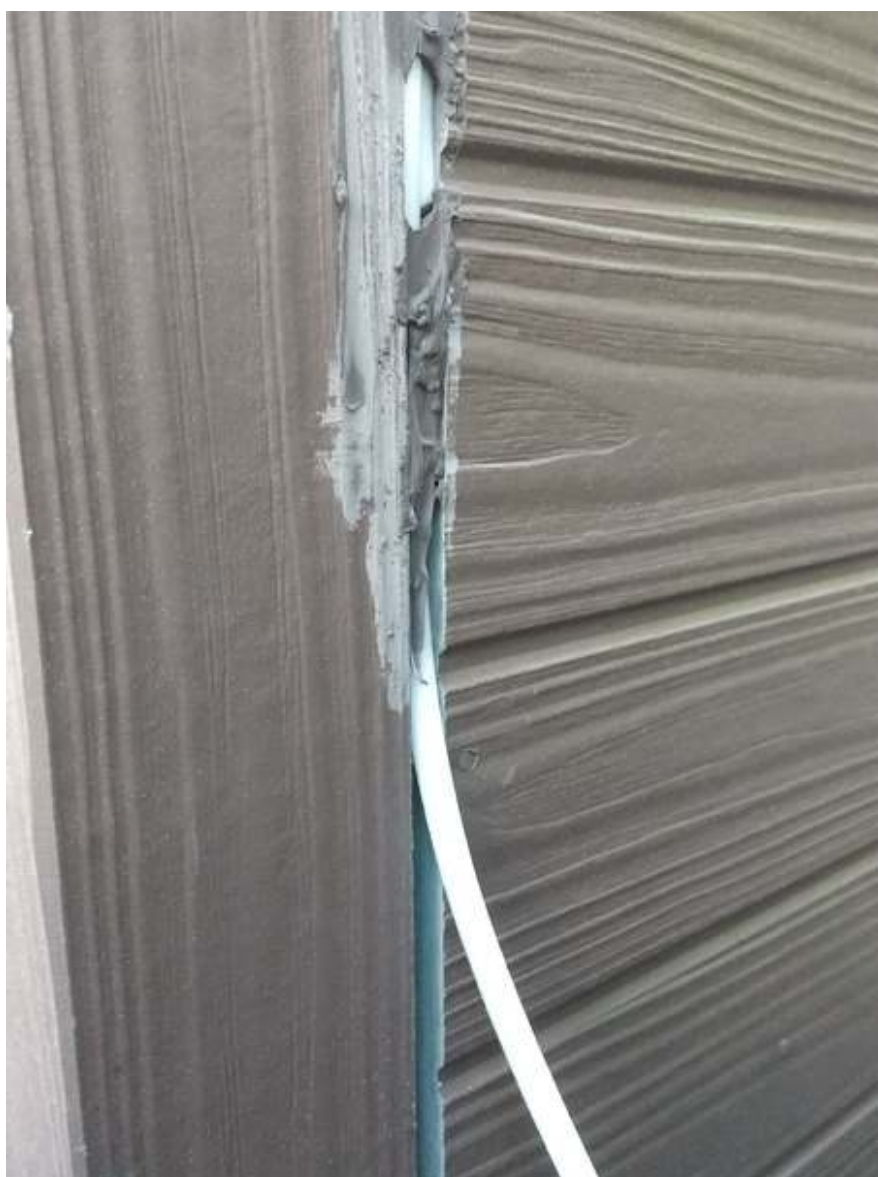
バックアップ材の飛び出し。劣化・剥離
