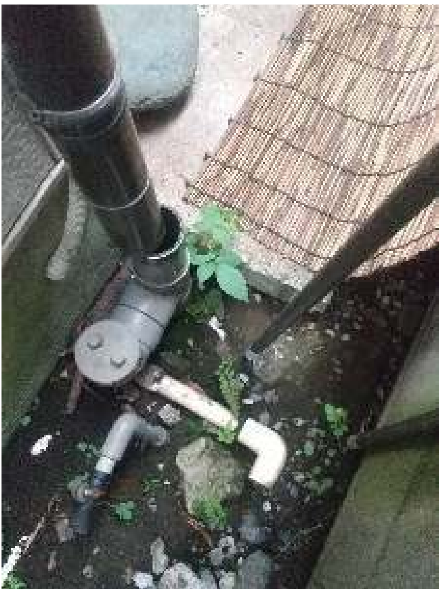
縦樋のつまり・破損跡
