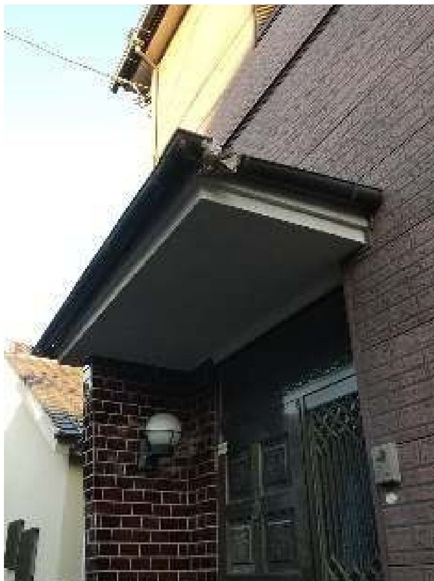
雨樋の継ぎ目の劣化・水はね跡
