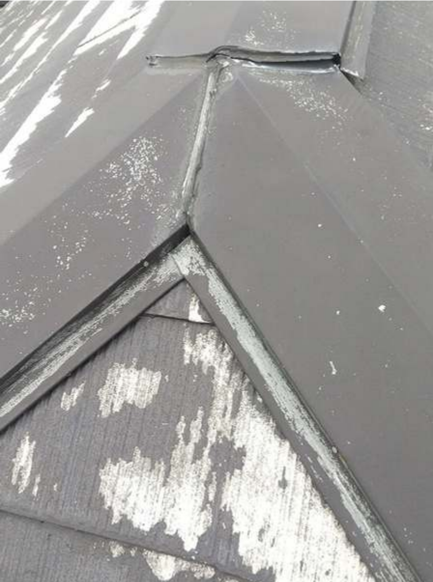
スレート瓦の表皮の剥がれ
